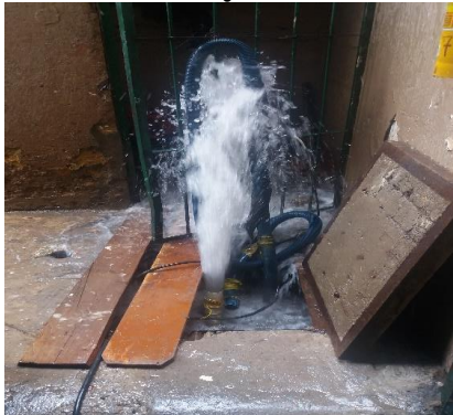
Tubería caldera área turcos Imagen 1
