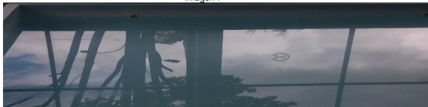
Fuga de agua área de piscina niños Imagen 7
