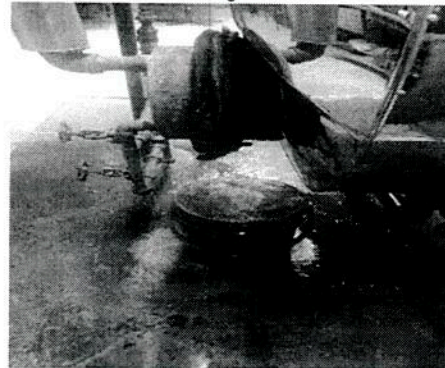
Caldera principal área piscinas fuga de agua Imagen 2
