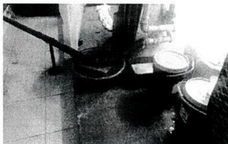
Máquina de secado con fuga área lavandería Imagen 3
